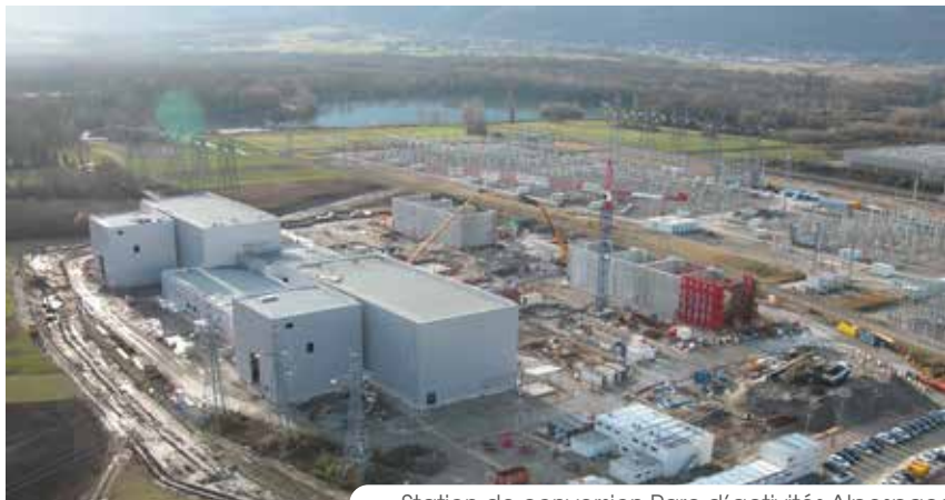
Station de conversion Parc d'activités Alpespace
