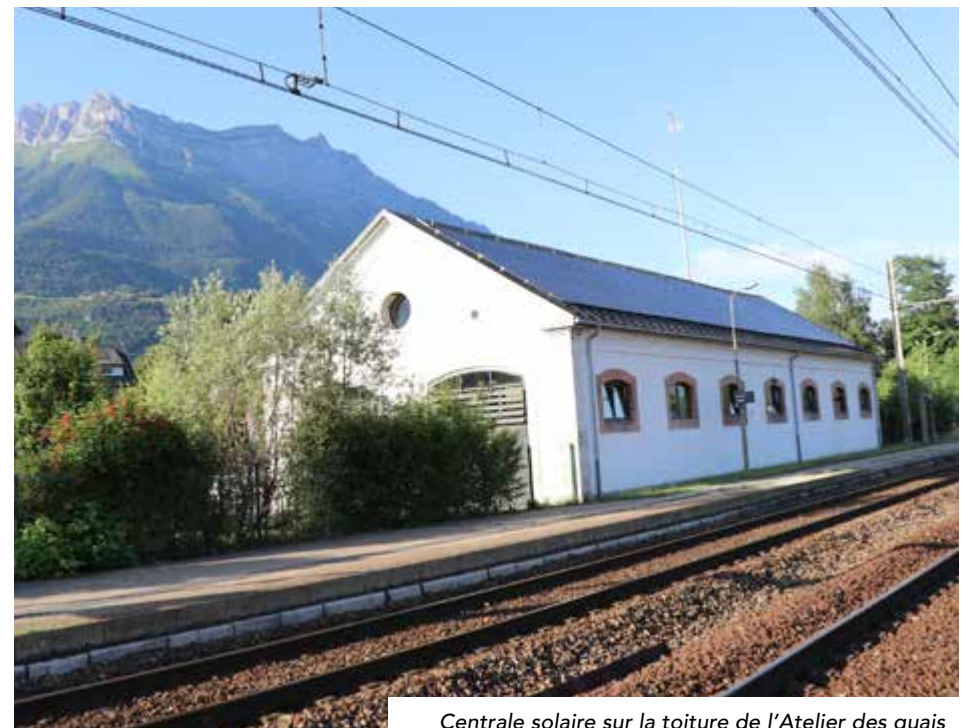
Centrale solaire sur la toiture de l'Atelier des quais
