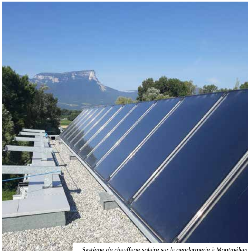
Système de chauffage solaire sur la gendarmerie à Montmélian
