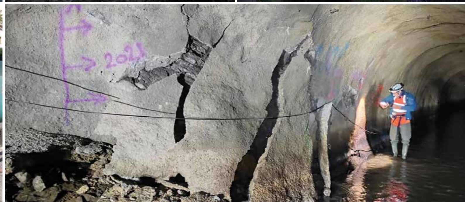
Caractérisation des dégradations du génie civil de la galerie de rejet au Rhône
